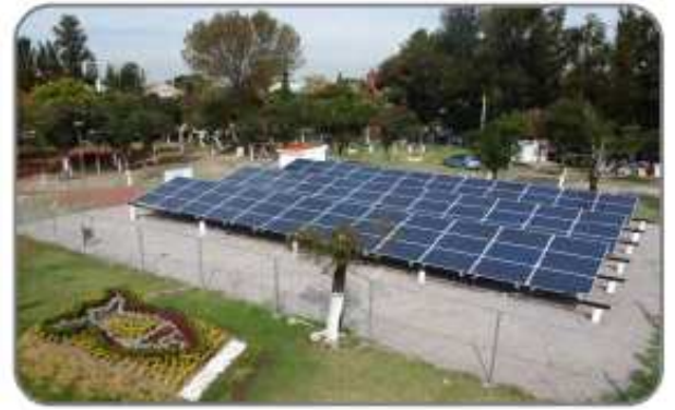
Sistema interconectado 24 kW Mpio. de Puebla.
